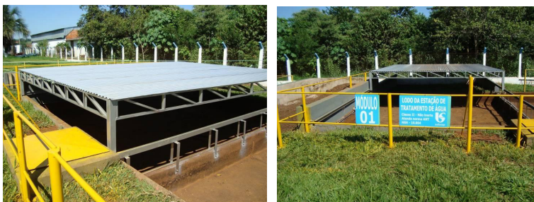
Figura 8: Cobertura móvel instalada no LD da ETA de Cardoso/SP.
